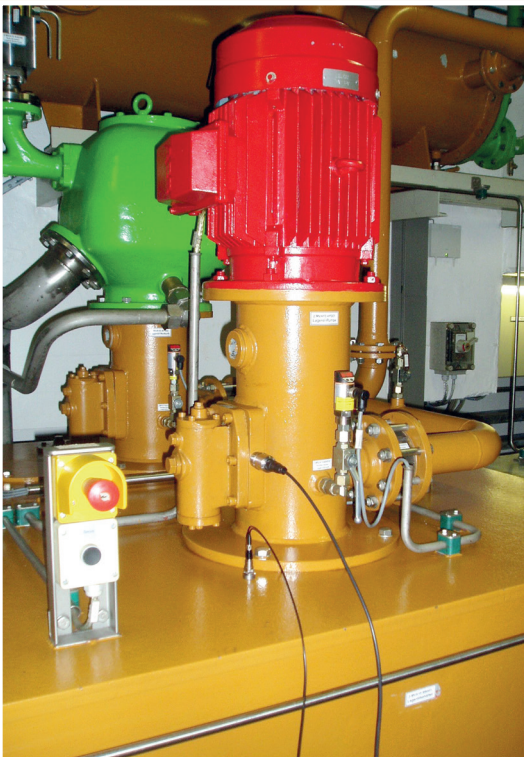
01 Messung vorher mit an Stör- und Empfängerseite angebrachten Sensoren: Die 300 kg schweren Schraubepumpen verursachen einen Betriebslärm von 86 dB
